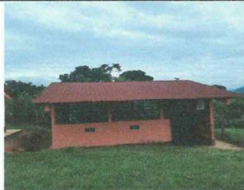
Foto 2: se observa el deterioro en las laminas del aula de preprimaria así como la necesidad de pintar las paredes del aula
