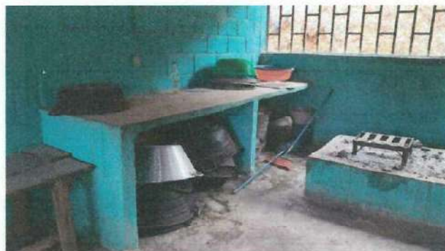
Foto 4: La cocina del establecimiento no cuenta con espacios que permitan la higiene en la preparación de los alimentos y para guardar los utensilios de cocina
