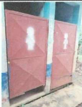
Foto 1: Las puertas de los cuatro baños (niñas-niños) de preprimaria se encuentran deterioradas por lo que es necesario sustituirlas
