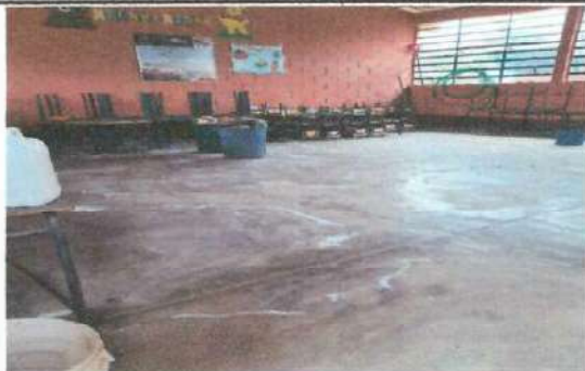
Foto 1: el piso del aula necesita ser mejorado para comodidad y que sea un ambiente agradable para los niños
